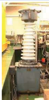
先の初代加速器の高圧絶縁変圧器(非公開)
